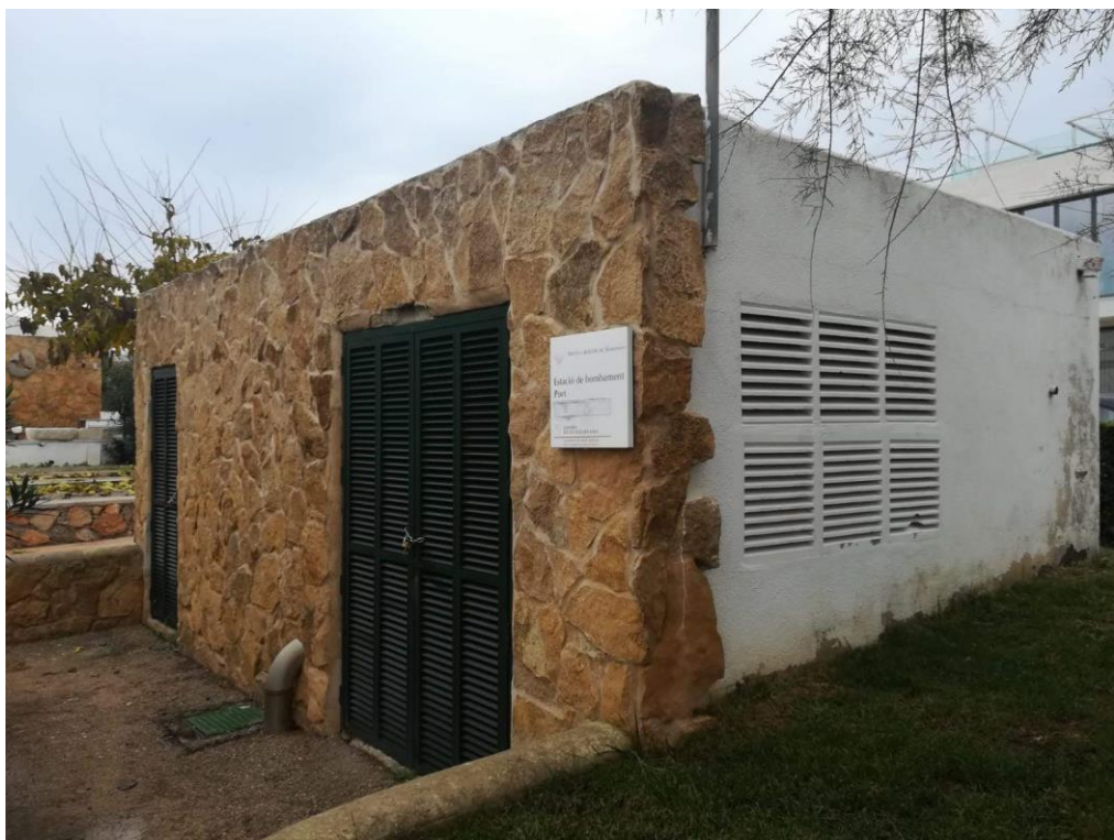
Fotografia 10. Imatge de l'EBAR del Port
