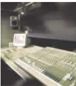
Cabina de control
